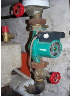
Heizungspumpe mit Stufenregelung
